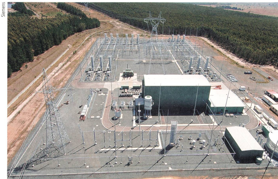
Konverterstation eines vergleichbaren Projektes in Australien.
