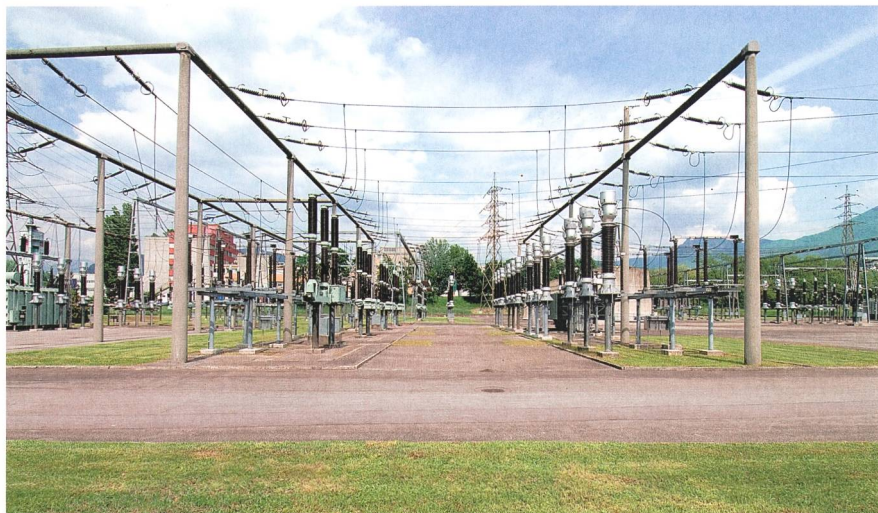
Figura 5 Sottostazione a Manno.
