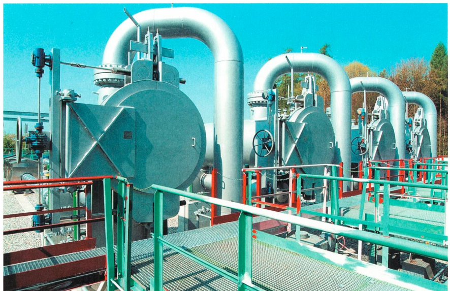
Bild 1 Messstation Wallbach der Transitgas-Leitung.
