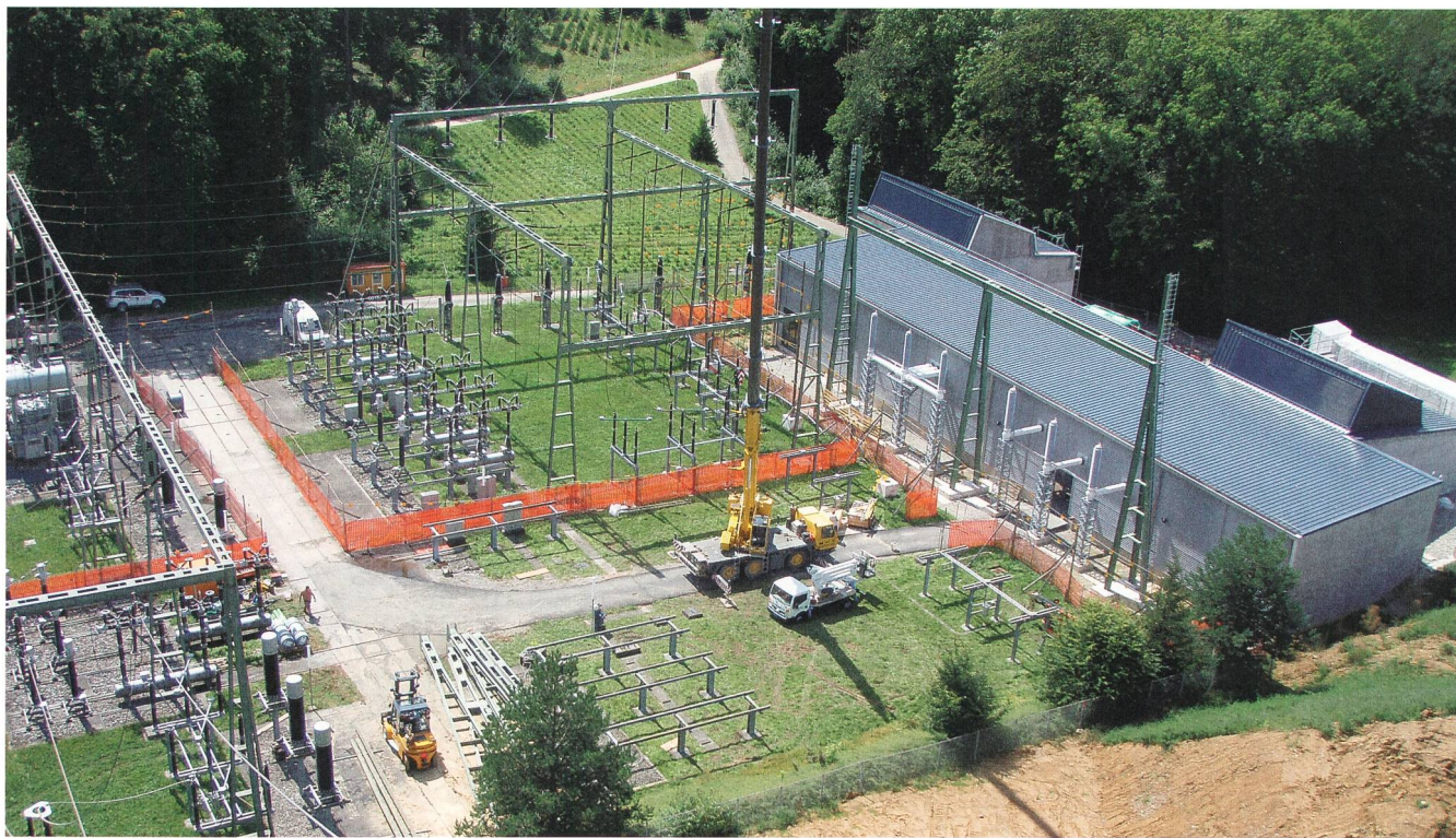
Das Unterwerk Froloo in Therwil (BL) aus der Luftperspektive.
