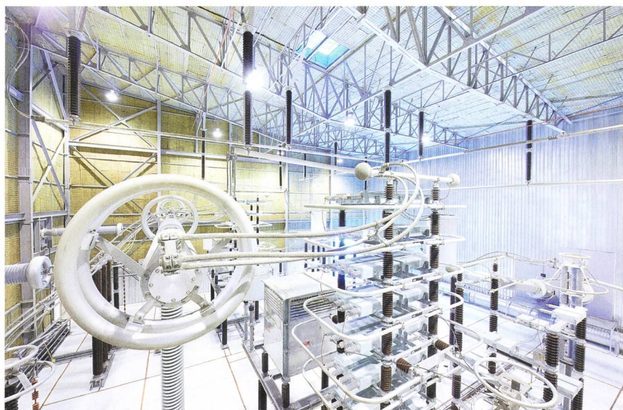
Eine HGÜ-Umrichterstation von ABB.
