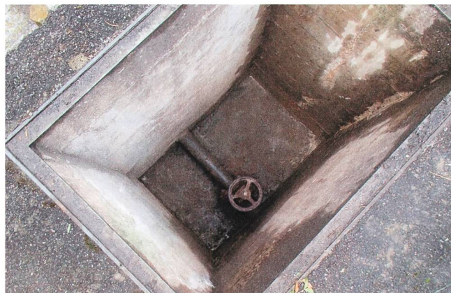
Schacht mit Entleerungsschieber der Druckleitung.
