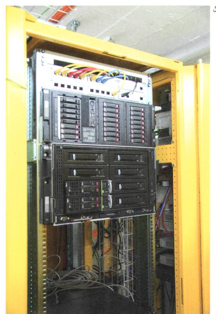
Bild 3 Blick ins Rechenzentrum. Dank der tieferen Temperatur in der Höhenlage benötigen die Server weniger Kühlung.
