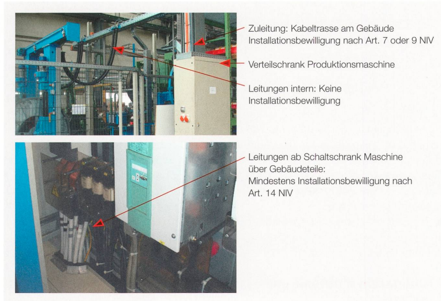
Foto 3 Errichten des Erzeugnisses (Produktionsmaschine) setzt das Verlegen von elektrischen Leitungen voraus.
