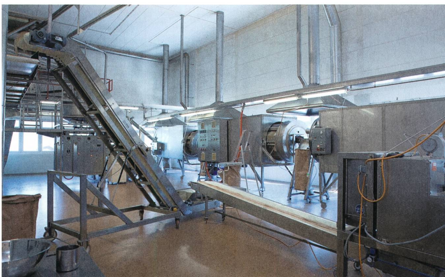
Elektrische Antriebe sind aus der Produktion und dem Alltag nicht wegzudenken – wie hier in der Biomüllfabrik Familia.
