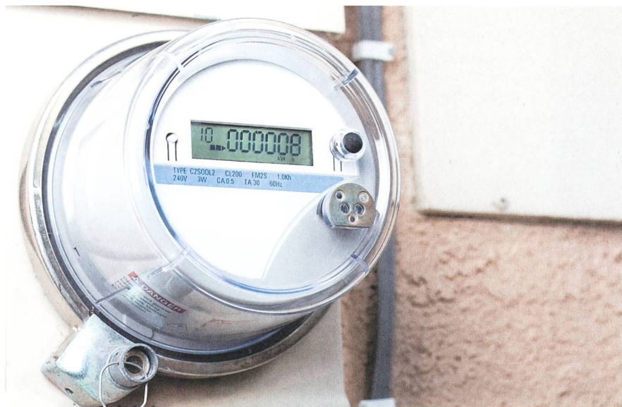
Les compteurs intelligents de demain serviront-ils à répartir le manque d'électricité ?
