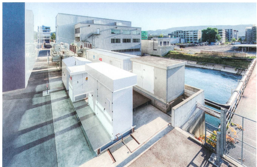
Die Speicherbatterie kann bis zu 500 kWh Energie ins Verteilnetz einspeisen bzw. von dort beziehen.
