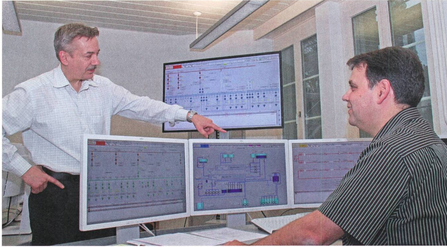
Die Bildschirme zeigen eine grafische Übersicht über das Netz. Die Farbe der Leitung zeigt beispielsweise, von welchem Unterwerk der Strom eingespeisen wird. Links im Bild Patrick Bader, bei Regio Energie Solothurn verantwortlich für das Leitsystem.
