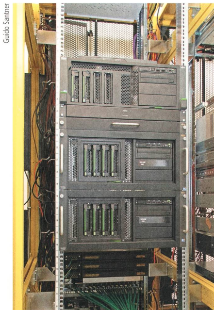
Das Leitsystem läuft auf einem Windows 8 Server mit gespiegelter Harddisk (Raid 1).
