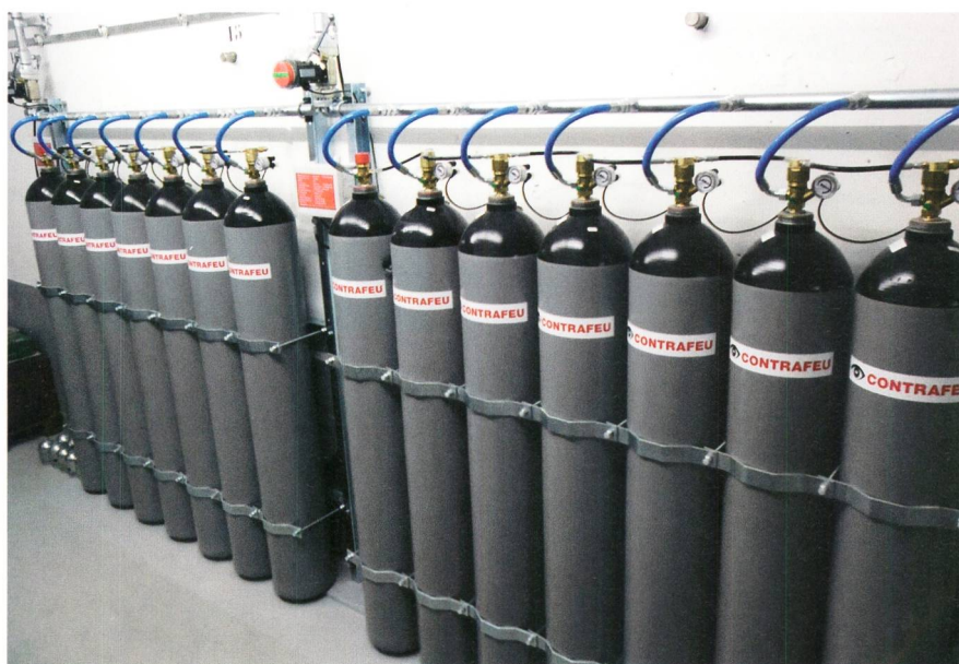
Stickstoffflaschenbatterie für zwei Löschbereiche mit mechanischer Blockiervorrichtung.
