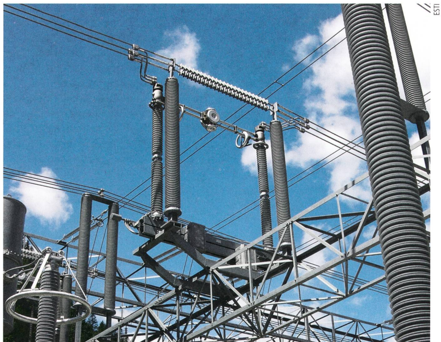
L'ESTI veille à ce que les installations à courant fort soient planifiées, construites et entretenues de façon sûre et écologiquement rationnelle.
