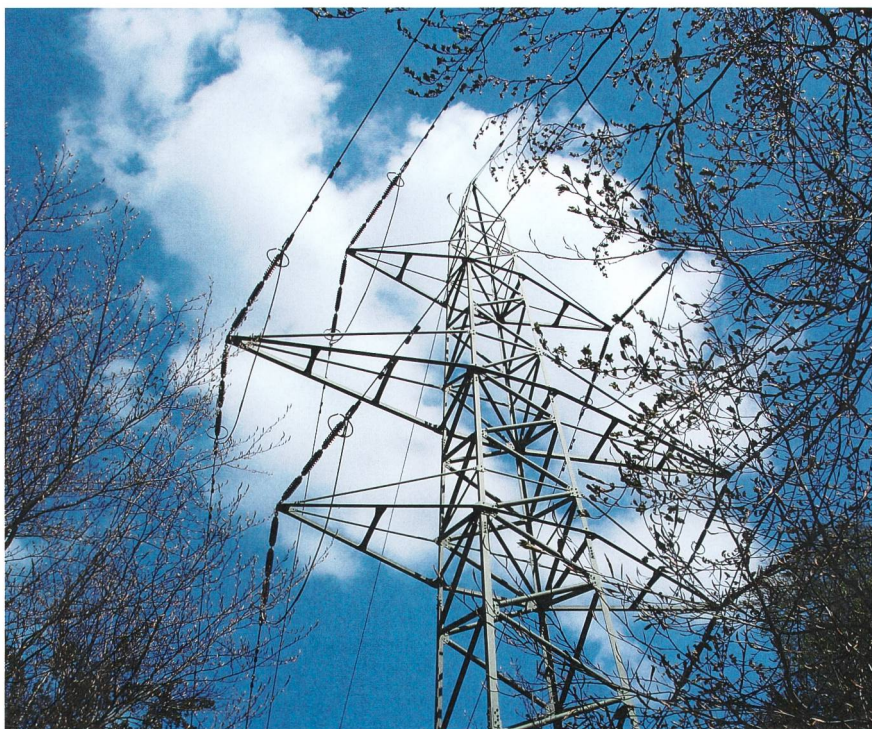
Das ESTI sorgt dafür, dass Starkstromanlagen sicher und umweltgerecht geplant, erstellt und gewartet werden.
