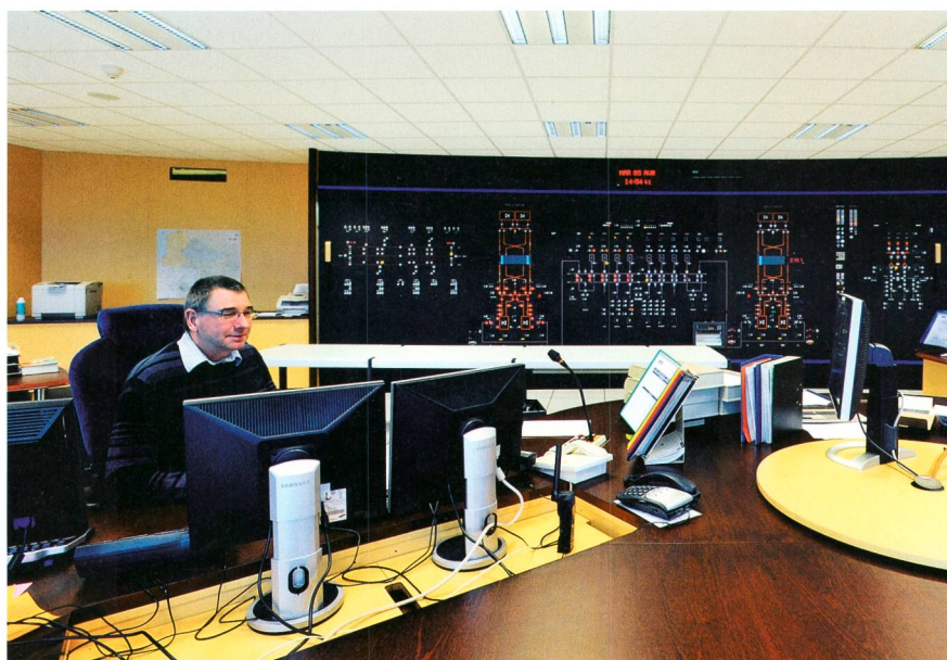
Kommunikation ist die Grundlage der intelligenten Steuerung von Smart-Grid-Einheiten.
