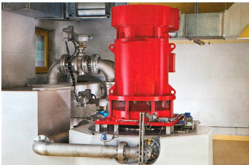
Figure 8 Turbogroupe Pelton sur les eaux usées de Verbier/VS, centrale du Profray (débit : 100 l/s, chute : 430 m, puissance électrique : 350 kW, mise en service en 2008).
