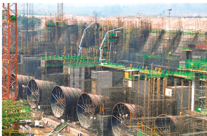
Figure 4 Mise en place de l'armature des aspirateurs de la centrale rive droite en cours de construction, 30 août 2012.
