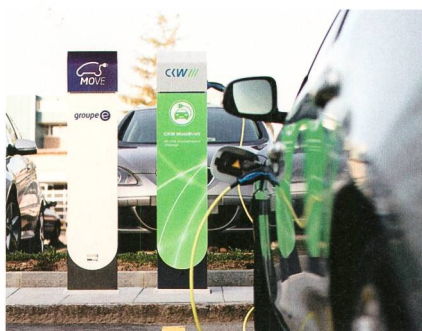
Ladesäulen von Groupe E und CKW.
