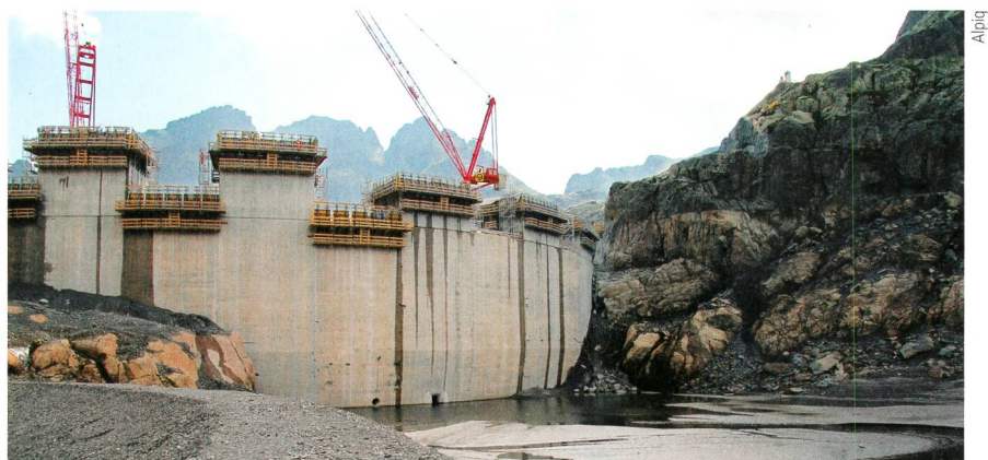
Bild 1 Auch Pumpspeicher-Projekte wie Nant de Drance im Wallis (im Bild: Baustelle zur Erhöhung der Staumauer Vieux-Emosson) blicken einer unsicheren Zukunft entgegen.
