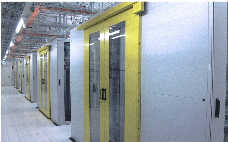
Bild 4 Die Zulufttemperatur beträgt innerhalb der Kaltgang-Einhausung rund 27 °C.
