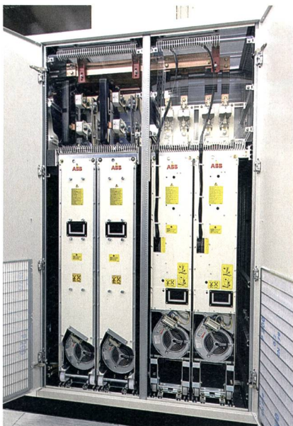
Bild 1 Einer von vier Schränken der Leistungselektronik.
