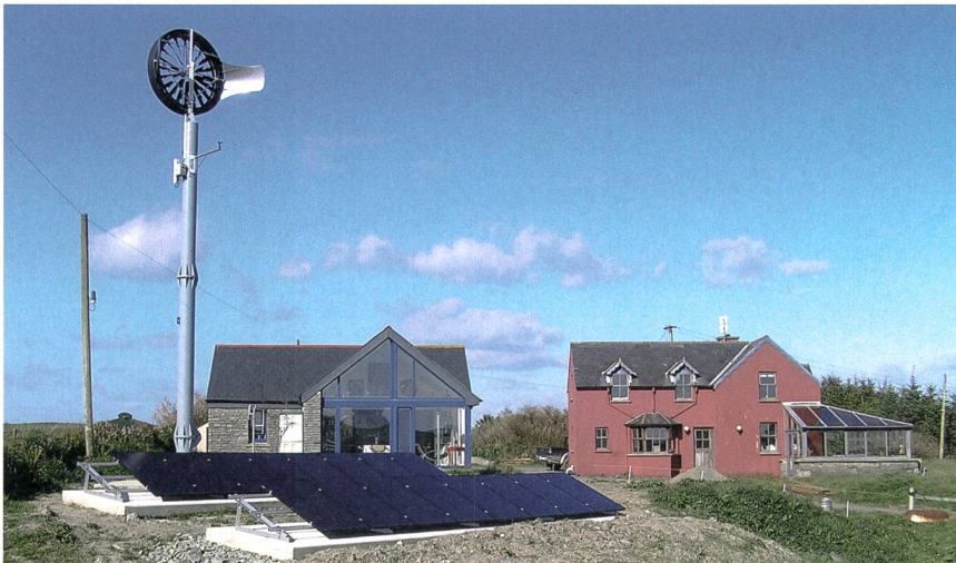
Eine Hybrid-Anlage in Irland kombiniert Wind- und Solarenergie.
