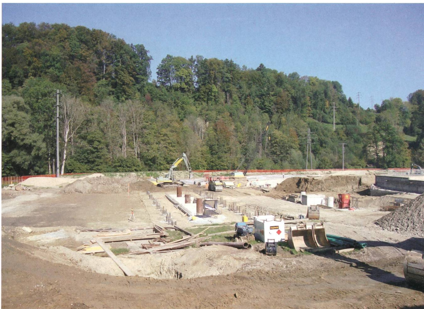
Vorbereitungen für eine Geothermieanlage: In der zweiten Hälfte dieses Jahres soll die erste Tiefenbohrung starten.
