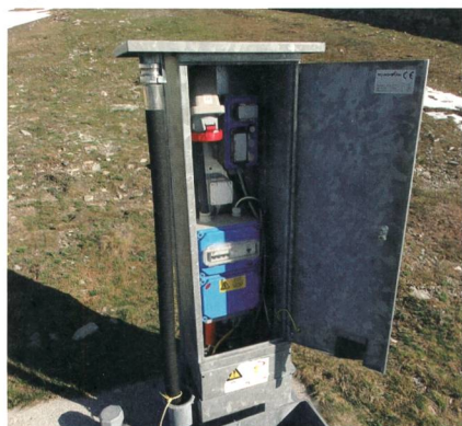
Figura 2 Armadio di distribuzione in superficie.
