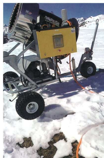
Figura 4 Conduttura di alimentazione del cannone da neve. Non conforme alle norme!
