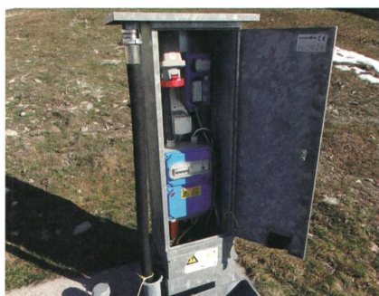
Illustration 2 Armoire de distribution en surface.
