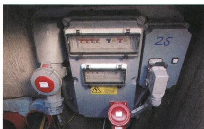
Illustration 1 Armoire de distribution souterraine.
