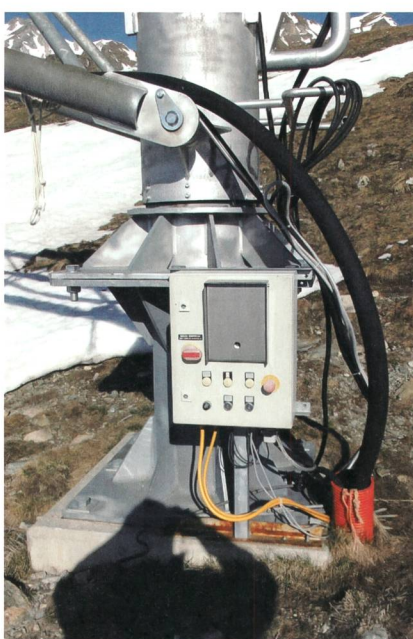
Figura 3 Cavo di alimentazione dell'armadio di distribuzione non protetto. Non conforme alle norme!
