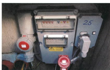
Figura 1 Armadio di distribuzione interrato.
