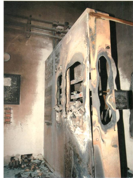
Bild 4 Beschädigte Schaltgerätekombination durch Kurzschluss.
