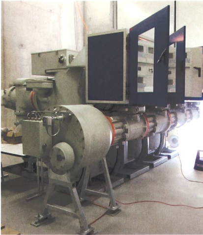
Bild 2 In der Energiezentrale Forsthaus eingesezte 132-kV-Schaltanlage.
