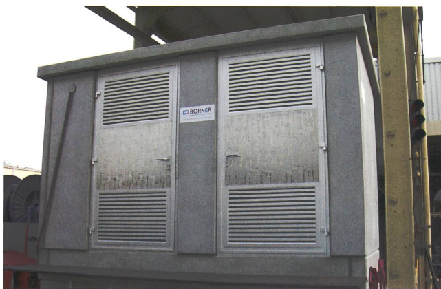
Der Prüfling mit maximaler Trafoleistung 1000 kVA.
