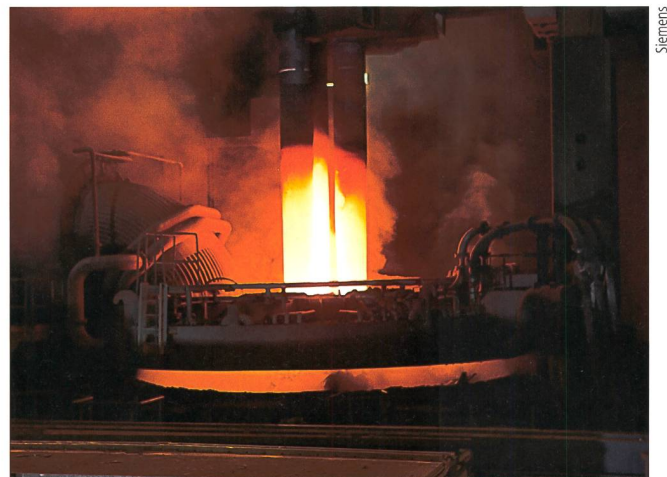
Ein Lichtbogenofen kann während eines Wartungsstillstandes mit dem optischen Messsystem ausgerüstet werden, das seine Produktivität dadurch um bis zu 2% erhöht.
