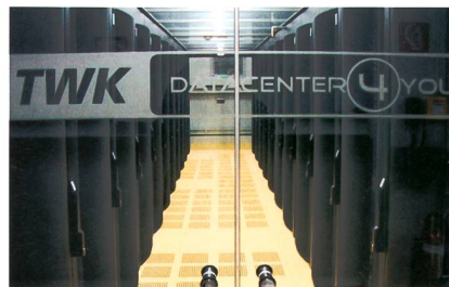
Das Datacenter4you zählt zu den modernsten und sichersten Rechenzentren Europas.
