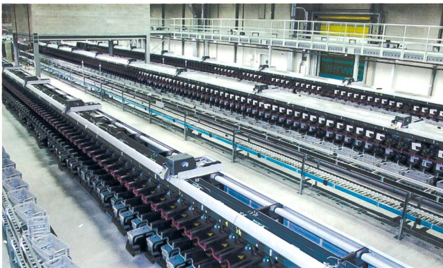
Trois des six machines de tri en fonction à Eclépens.
