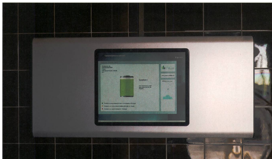
Dans le hall d'entrée, un écran économique indique la tendance de consommation du jour sur la base du résultat de l'année précédente.
