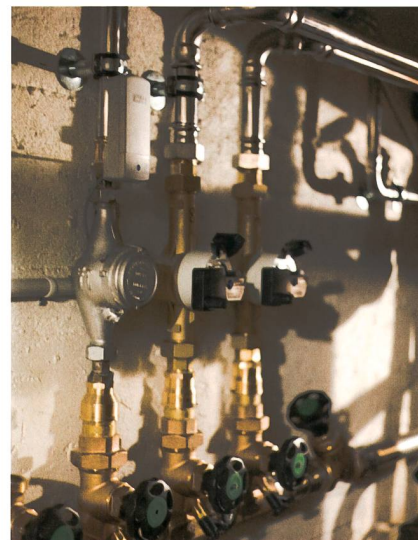
Dans le local technique de l'immeuble, un compteur intelligent est placé sur la nourrice pour mesurer la consommation d'eau des habitants.
