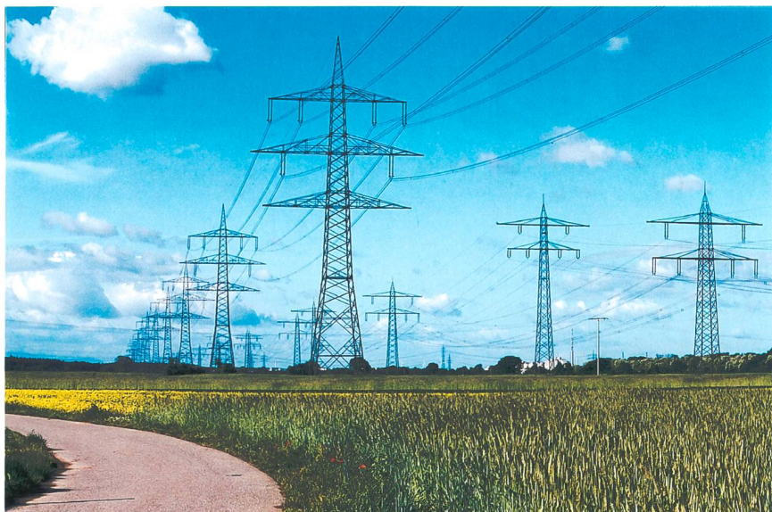
Vor allem aufgrund der steigenden Stromproduktion aus Windenergie müssen die deutschen Übertragungsleitungen erweitert werden.
