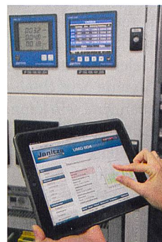
iPads ermöglichen nun eine komfortable Netzqualitätskontrolle.
