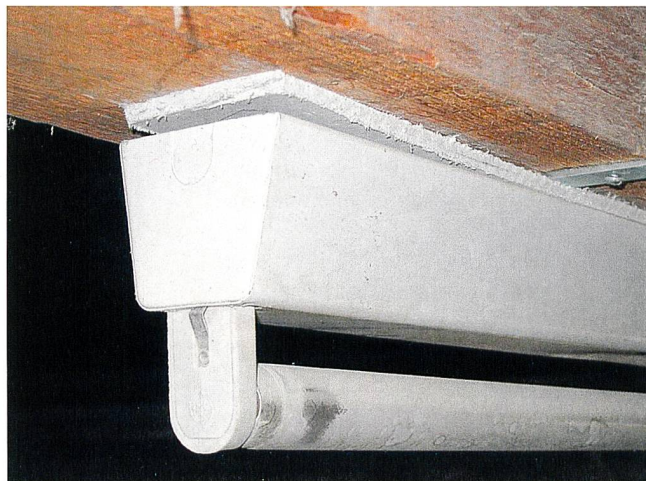
Asbesthaltige Leichtbauplatte unter FL-Armatur (schwach gebundener Asbest).
