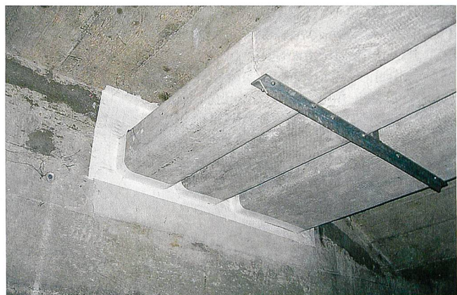
Condotto in cemento-amianto (Amianto fortemente agglomerato).
