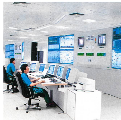
Software von SCS Info Tech ermöglicht die permanente Stromüberwachung.
