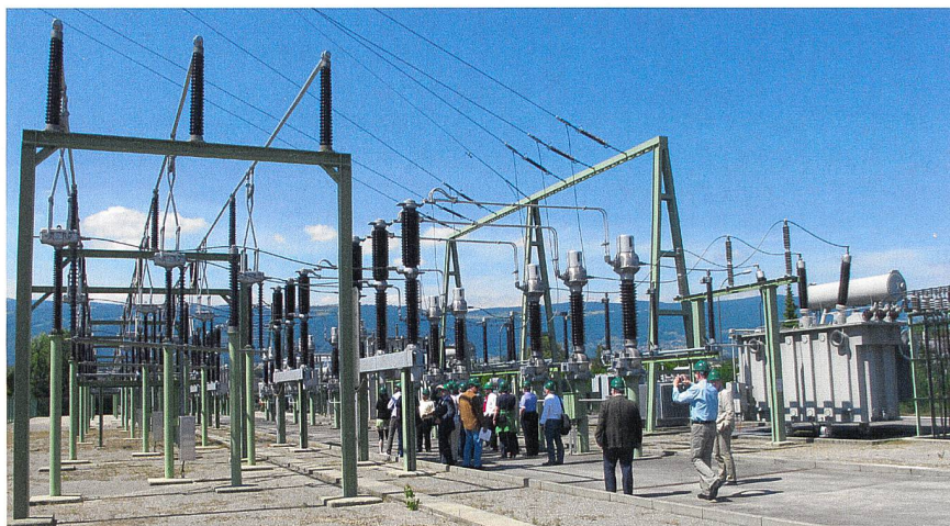
Visite du poste 125/20 kV de Romande Energie à Yverdon. De gauche à droite se trouvent les sélecteurs, les disjoncteurs, les groupes de mesure et le transformateur (125/20 kV).
