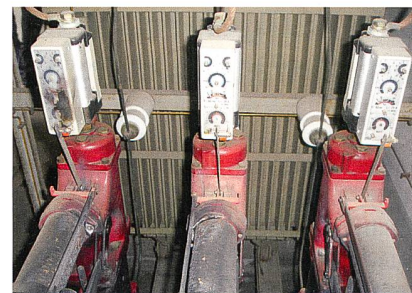
Bild 3 Brandspuren eines 3-poligen Kurzschlusses in einer Mittelspannungszelle, ausgelöst durch Eindringen in die Annäherungszone durch den Verunfallten. Er erlitt dabei schwere Verbrennungen, da er die persönliche Schutzausrüstung nicht verwendete.
