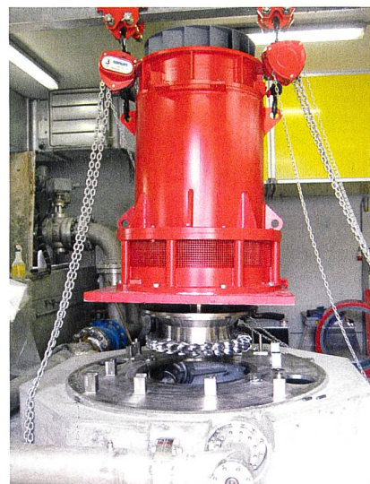
Turbine de Châble-Profay, sur les eaux usées de Verbier.
