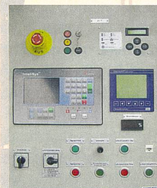
Steuerung mit Fernwartung und Netzanalyse Nachrüstbar !
