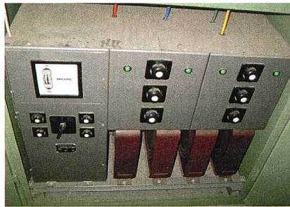
Un impianto di compensazione di corrente reattiva con la relativa regolazione.
