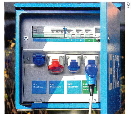
Die EKZ-Stromtankstelle mit 4 Steckdosen liefert EKZ-Mixstrom und EKZ-Naturstrom solar.
