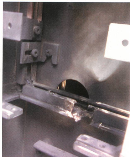
Bild 6 Der Erdschluss brannte ein grosses Loch in das Rahmenprofil und entzweite den Leiter L3.
