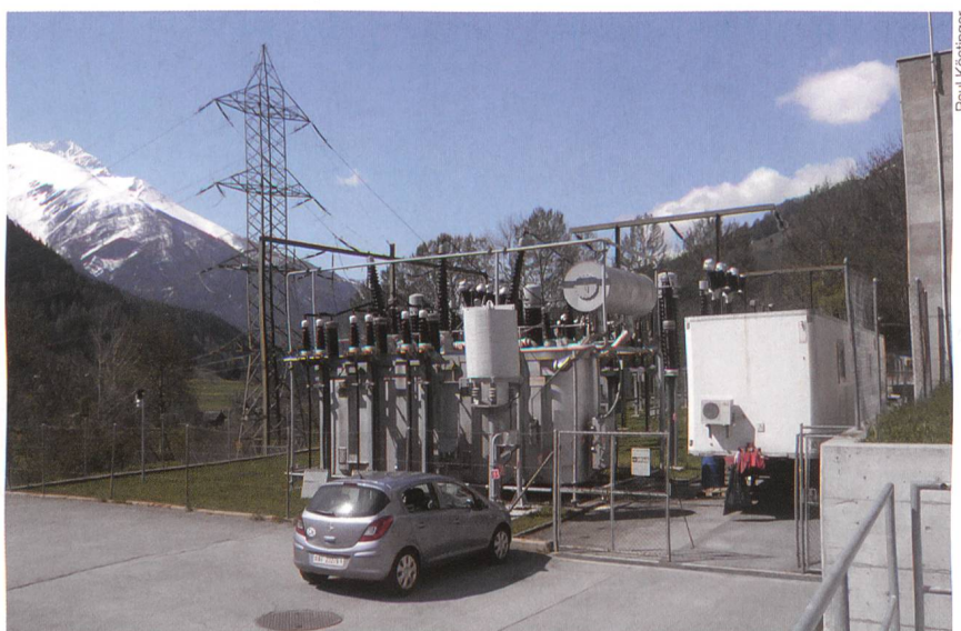
Bild 3 Moderne Ölregenerieranlage mit integrierter Wiederaufbereitung der Fullererde.
