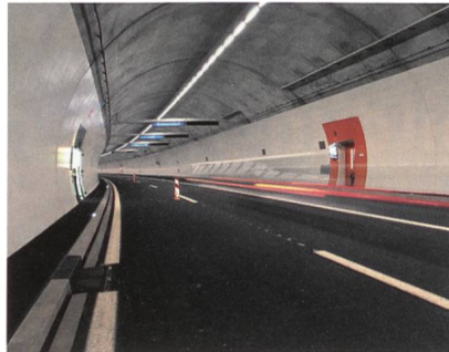
Beleuchtung von TridonicAtco im Üetlibergtunnel.
