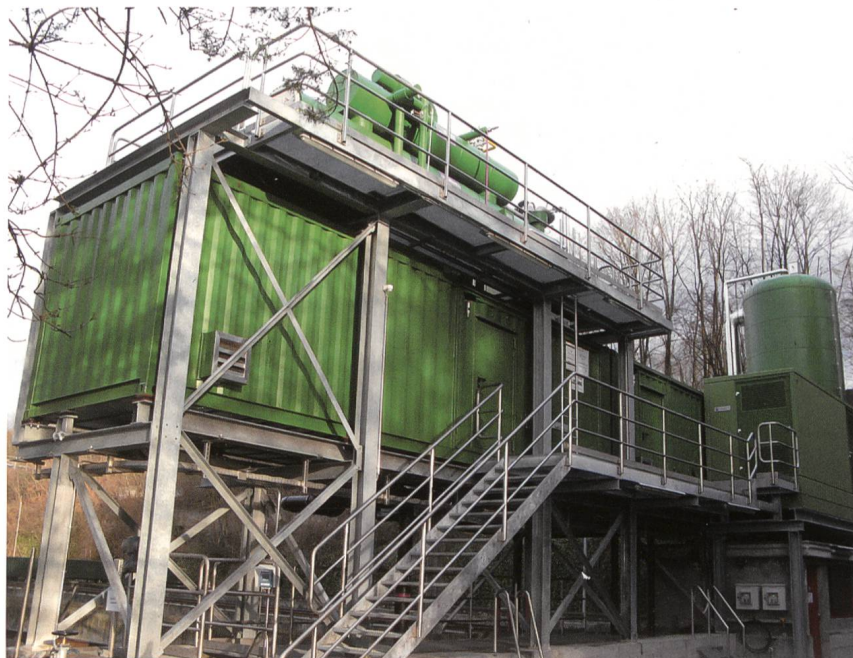
In diesem Container ist die 2,5-MW-Wärmepumpenanlage untergebracht.
