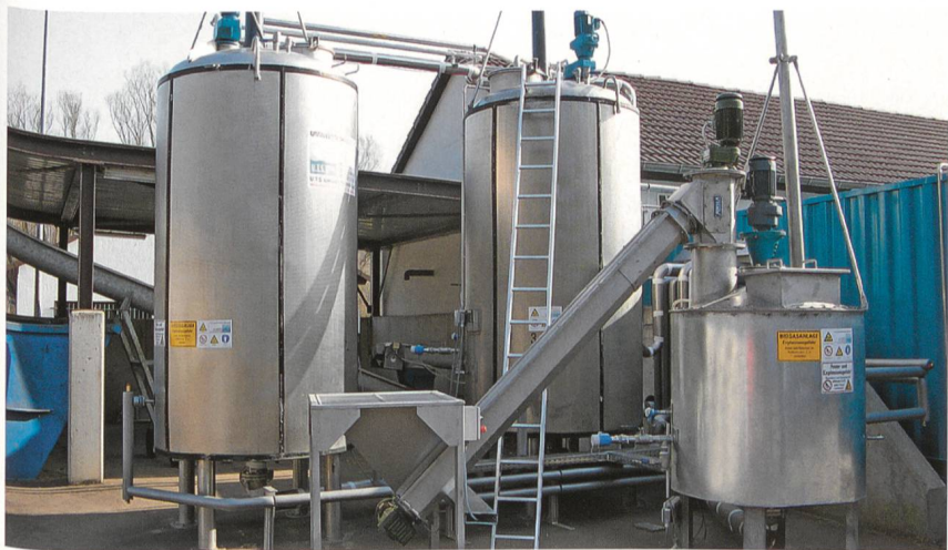
Die neue Biogasanlage lässt sich erstmals ausschliesslich mit Reststoffen, etwa Maisstroh, betreiben. Die Zugabe von Nahrungsmitteln ist unnötig.
