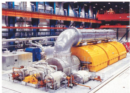
Dieser Generator liefert 2000 MVA – und ist auch nur eine rotierende Maschine.
