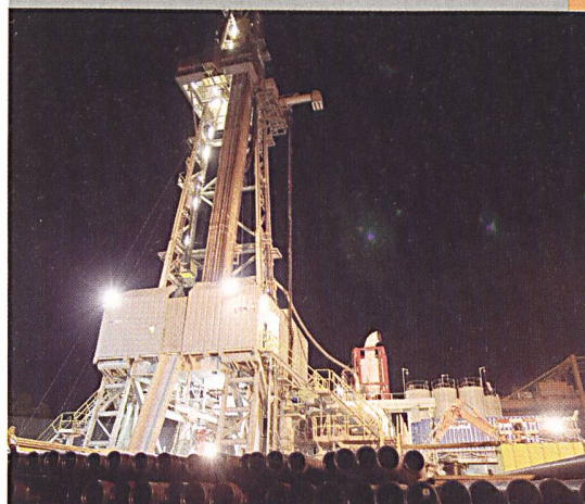
Bohrturm in Basel: Nach dem Beben wurden die Arbeiten für das geothermische Kraftwerk vorläufig eingestellt.
