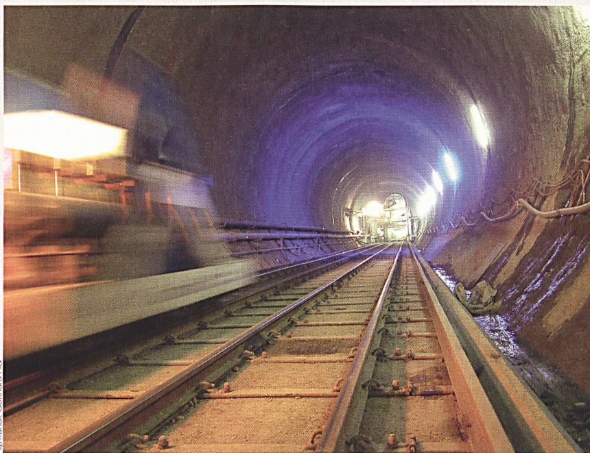
Das Konsortium kann für den Ausbau im Basistunnel bereits auf Erfahrungen zurückgreifen.
