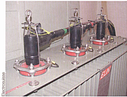
Bild 7 Primärseite des Transformators.
