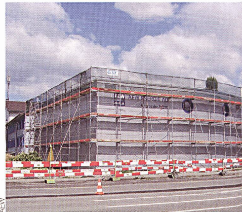
Neues Unterwerk in Rheinfelden
