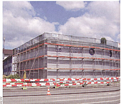
Neues Unterwerk in Rheinfelden
